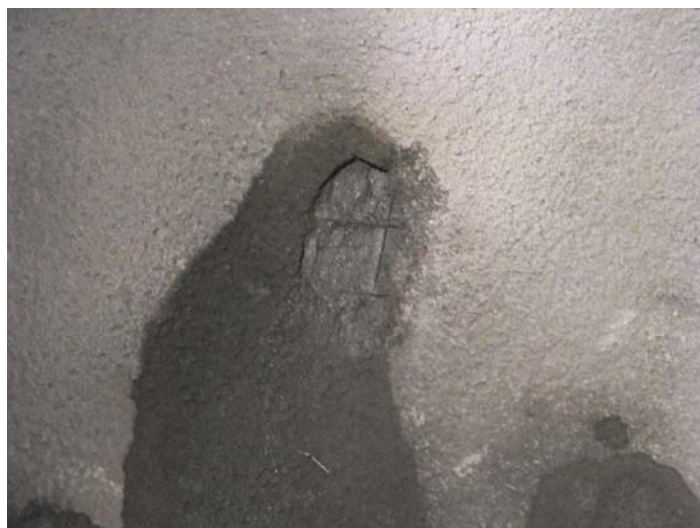
Bild 12: Typische Ablösung des unmodifizierten Spritzbetons bedingt durch drückendes Gebirgswasser
