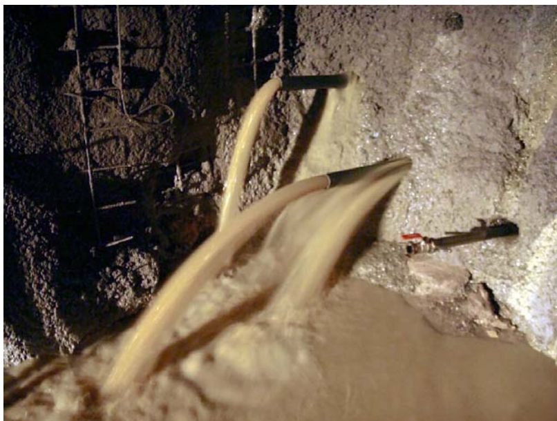
Bild 10: Wasseraustritt aus der mit Spritzbeton gesicherten Ortsbrust
