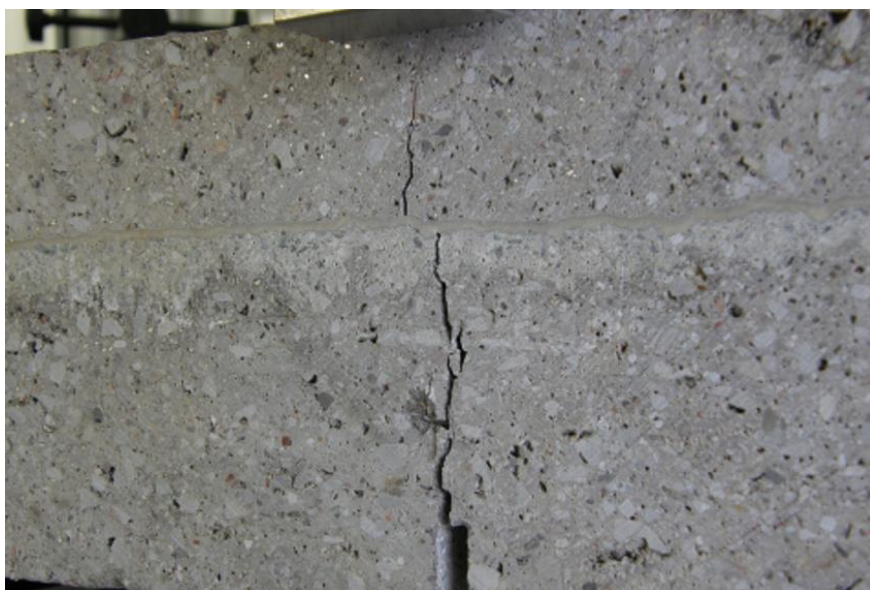
Bild 6: Ausschnitt Biegebalken bei einer Rissweite von 4,0 mm
