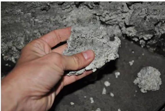
Bild 1: Zu Brei zerfallener Beton im Bosrucktunnel.
