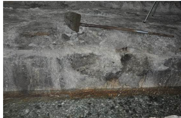
Bild 2: Starke Schädigung unterhalb des Geleiskörpers.
