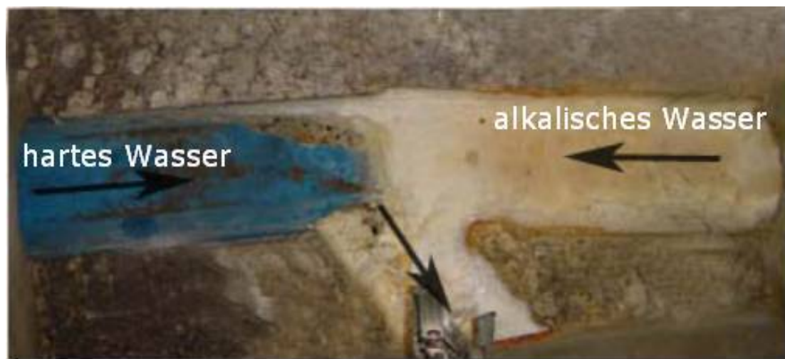
Bild 1: Versinterungen im Einlaufbereich der Stichleitung vom Injektionsschleier [2]
