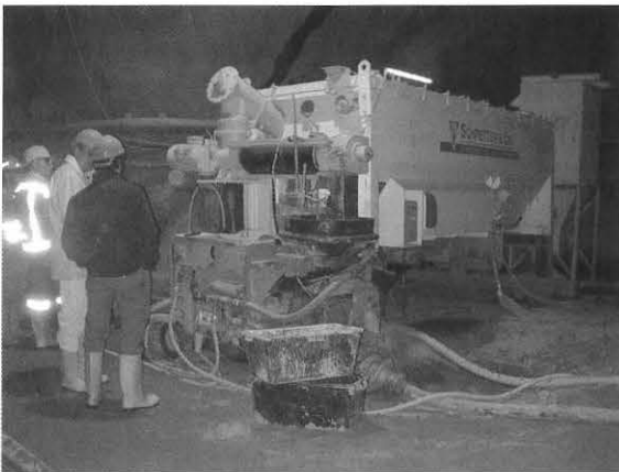
Bild 1: Halbnassanlage im Tunneleinsatz
