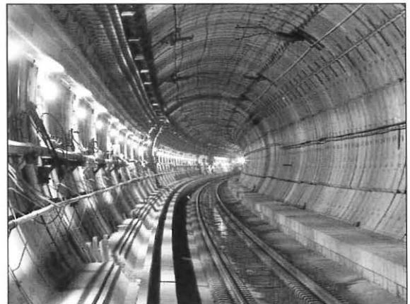
Bild 3: Eingleisige Tunnelröhre des Eurotunnels mit Brandsensoren, Feuerlöschwasserleitung und Verbindungsstollen zum Rettungstunnel
