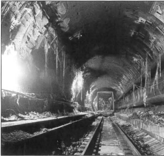
Bild 4: Tunnelabschnitt nach dem Löschen des in Brand geratenen Lkw-Pendelzuges
