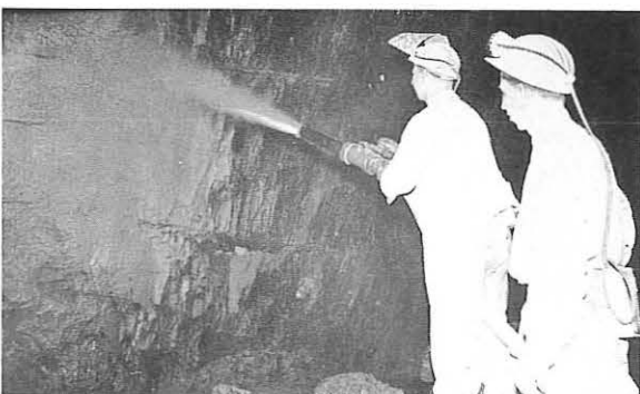
Bild 1: Provisorische Sicherung des unmittelbaren Arbeitsbereiches
