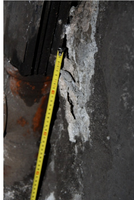
Bild 2: Schadhafter Spritzbeton neben Fuge
