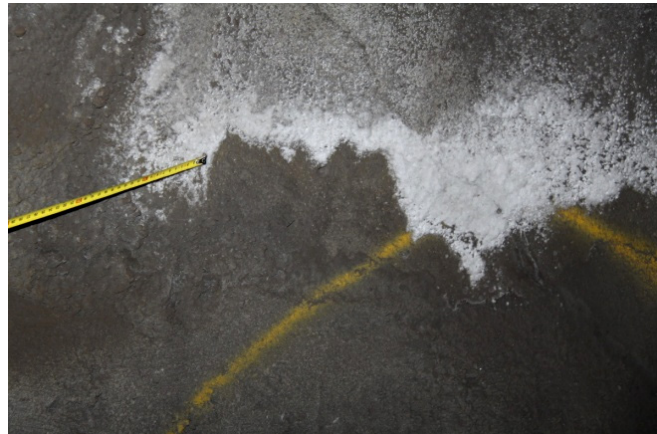
Bild 4: Ausblühung entlang eines Risses
